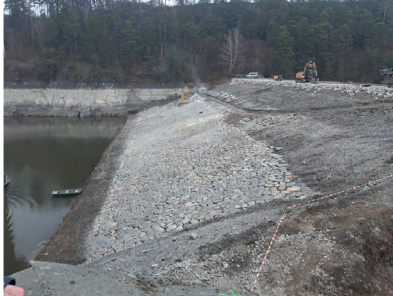
Práce na opevnění návodního líce hráze kamennou rovininou ↑ Nový bezpečnostní přeliv má větší kapacitu ↓
